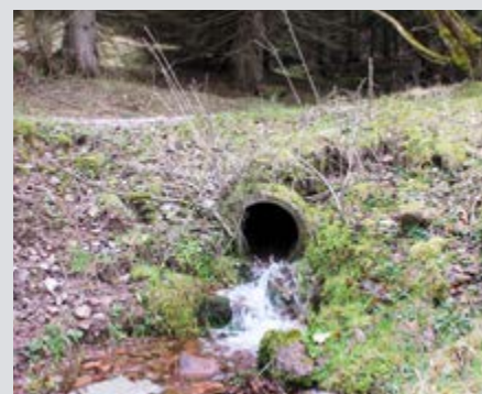
Rohrdurchlass mit Absturz vor Umbau
